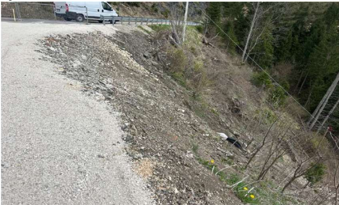
Figura 12 - Scarpata lato terrazzamento
