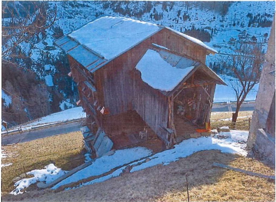
Mason in loc. Rucavà con copertura sul ponte di accesso a monte;
